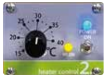
床ヒーターコントロール
